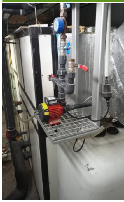
Figura 3. Sistema de recuperación y almacenaje de aguas.
