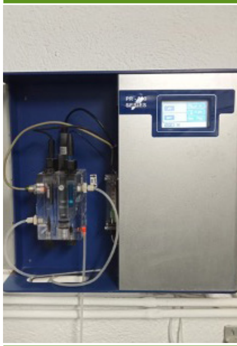
Figura 4. Control de química de piscina.
