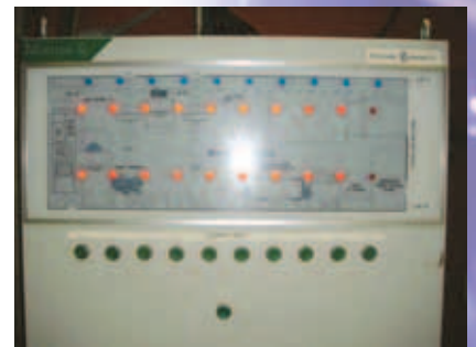
Foto 2. Cuadro de control de luces por líneas en la nave ligera.
