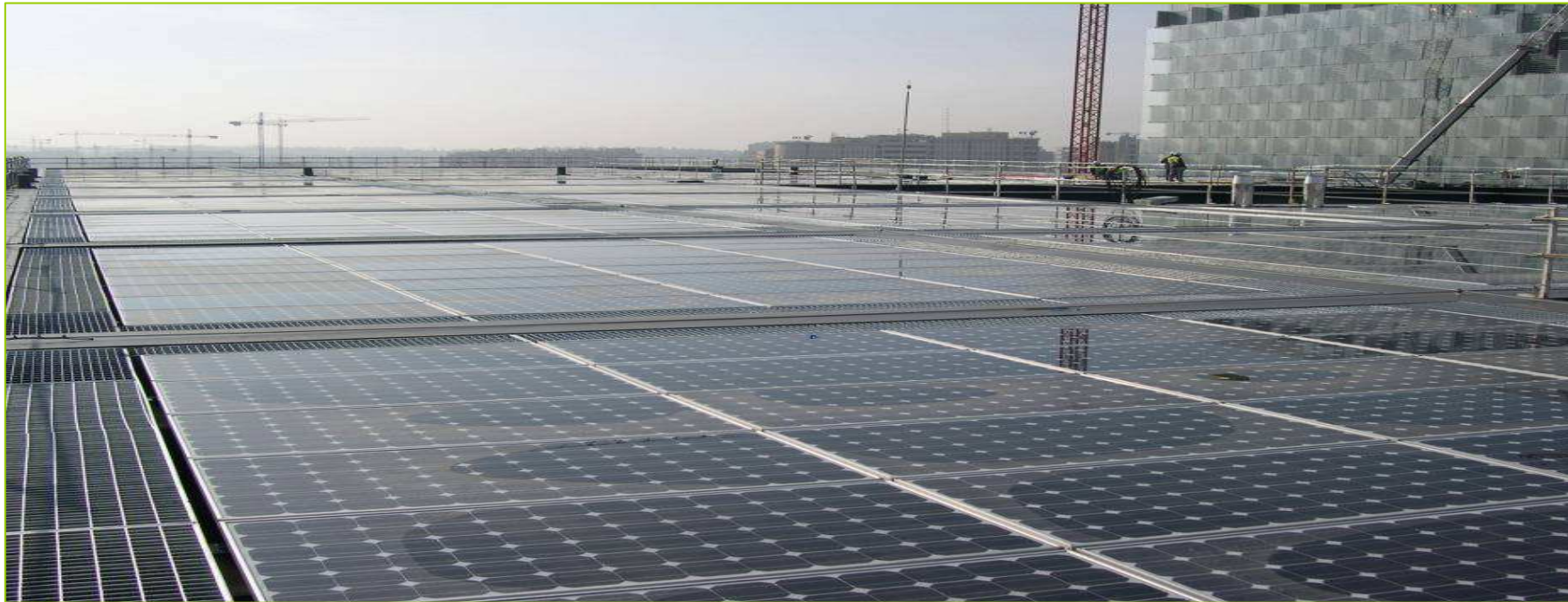
Instalación Fotovoltaica 2800 KW
